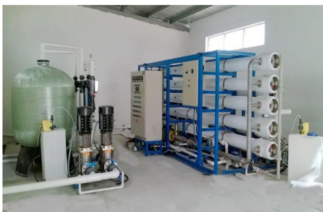
Рис.2 Оборудование для очистки методом обратного осмоса
